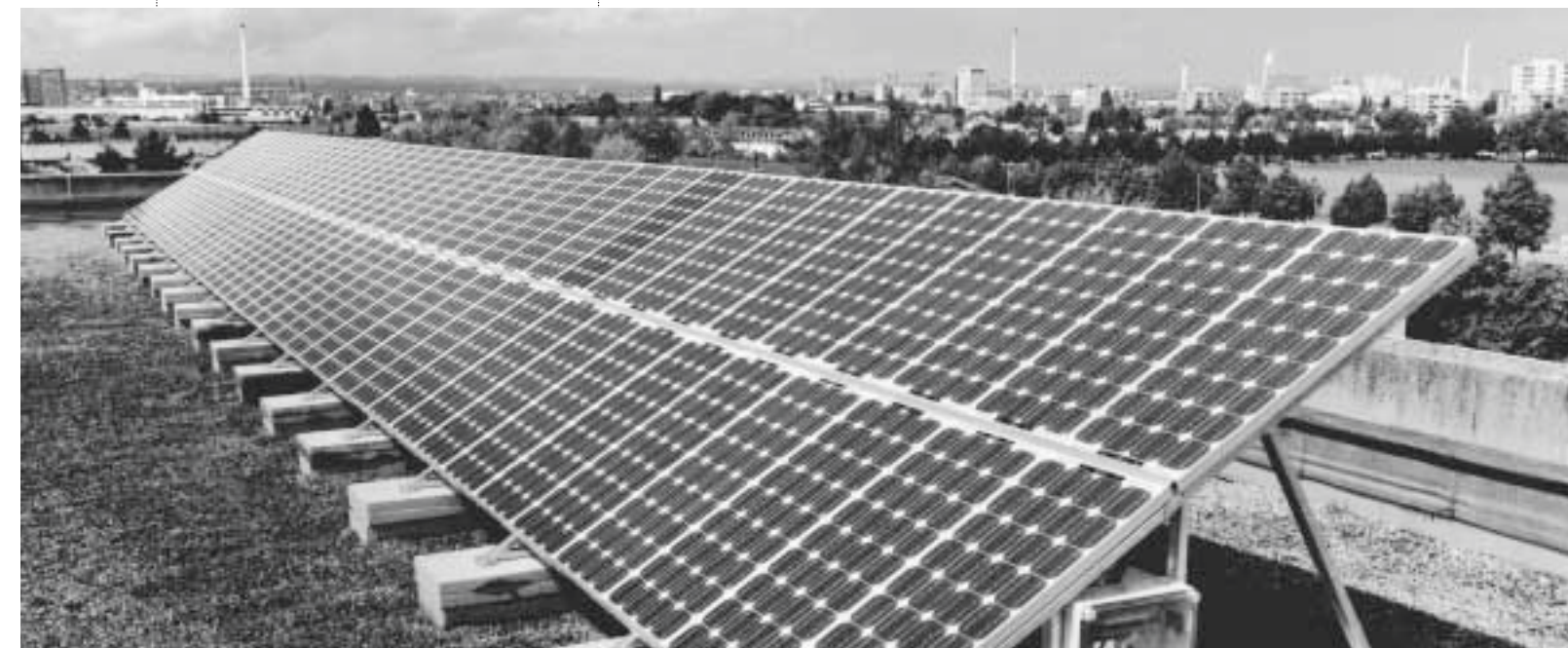
Fotovoltaikanlage auf dem Dach des Gymnasiums Bäumlhof (Foto: Niggi Bräuning)
