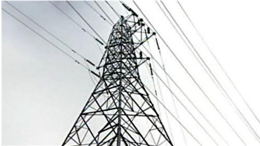
Un pylône à L'Île-du-Prince-Édouard [archives]
