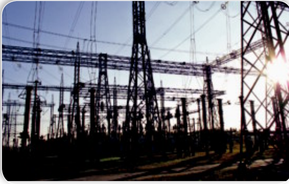
محطة توليد كهرباء شمال القاهرة
