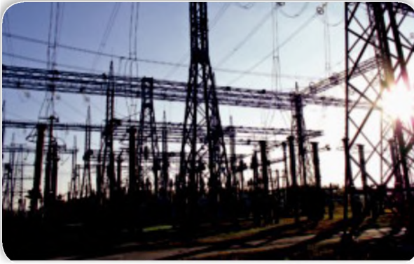
محطة توليد كهرباء شمال القاهرة
