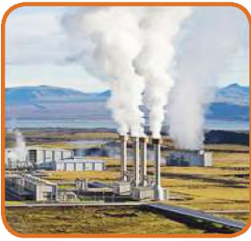
محطة غاز طبيعي
