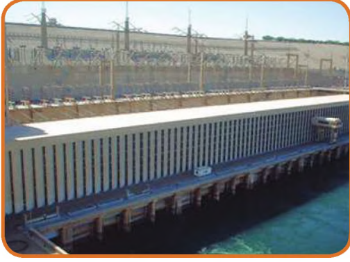
محطة السد العالي لتوليد الكهرباء
