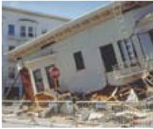
Gambar 3.6 Akibat gempa bumi
