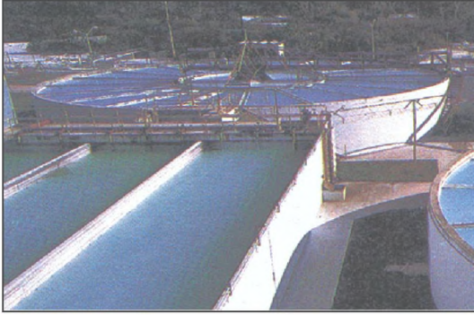
شكل (٤) معالجة مياه الصرف الصحي
