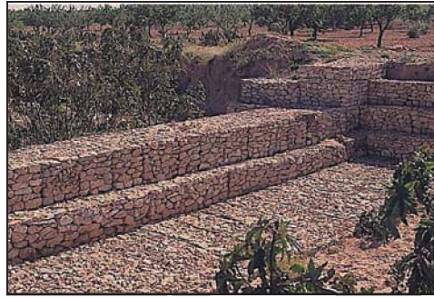
صورة وحدة تغذية مائدة سطحية مقامة في مجرى واد سفيشيف بجهة القيروان.
